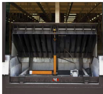
Vérin de levage avec vanne anti-chute
